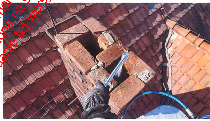
Fot. 4 Gaszenie pożaru sadzy w przewodzie kominowym (zdjęcie wykonane podczas ćwiczeń)
