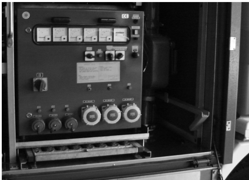
Fot. nr 87. Przykładowy pulpit obsługowo-kontrolny wraz z przyłączami agregatu na stałe wbudowanego do pojazdu pożarniczego
