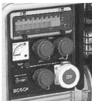
Fot. nr 89. Przykładowy panel obsługowo kontrolny
